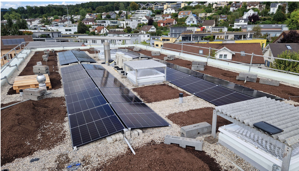
Bild 3 Solarpanels auf Nordtrakt
