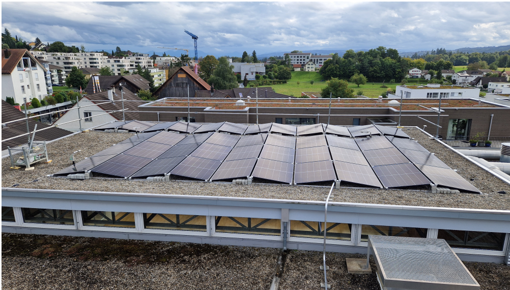
Bild 1 Solarpanels über Gemeindesaal (Südtrakt)
